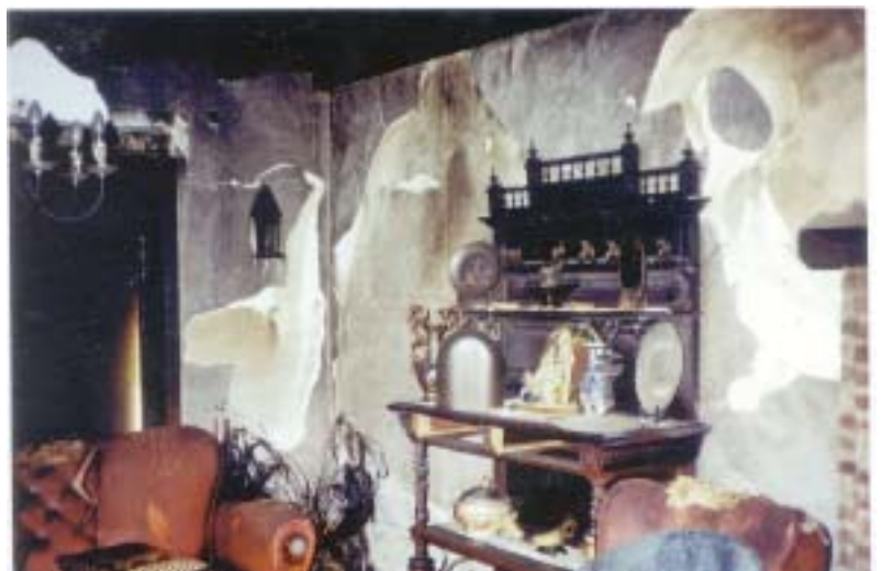
Resultaat van een overspanning - IJsschol (Heist op den Berg) 10 jaar later is de schade nog niet volledig geregeld !
