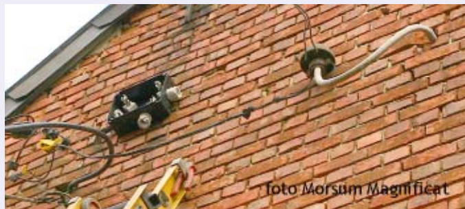
Er komen nu twee lasdozen plus de verbinding tussen de twee, en dat allemaal op de voorgevel !
