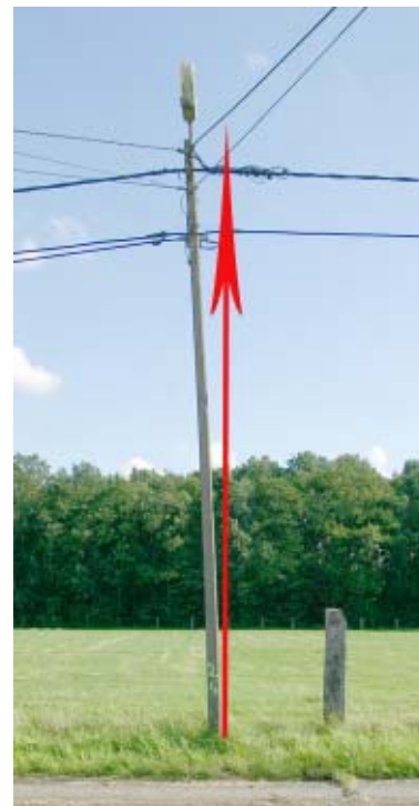
De paal aan de Mechelbaan die te kort, te laag, te zwak (art.155.04 AREI), etc. is, had evengoed kunnen omvallen !
