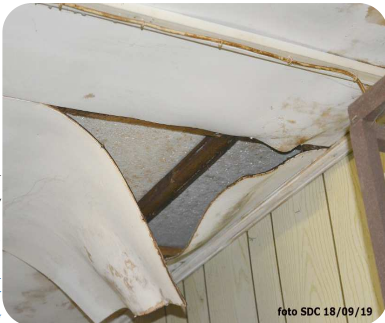
Het plafond van de woning te Bassevelde, van vocht gesproken en toch een bezettingsvergoeding gelijk aan de huur !!
