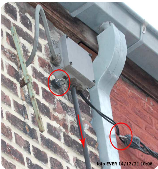
Twee inbreuken: Aansluitkabel -pijl- niet bevestigd - AREI Boek 1 - 5.2.9.5. Verticale trekkrachten. Aftakkabel los van de verankering -cirkels- Aarschotsesteenweg 43.
