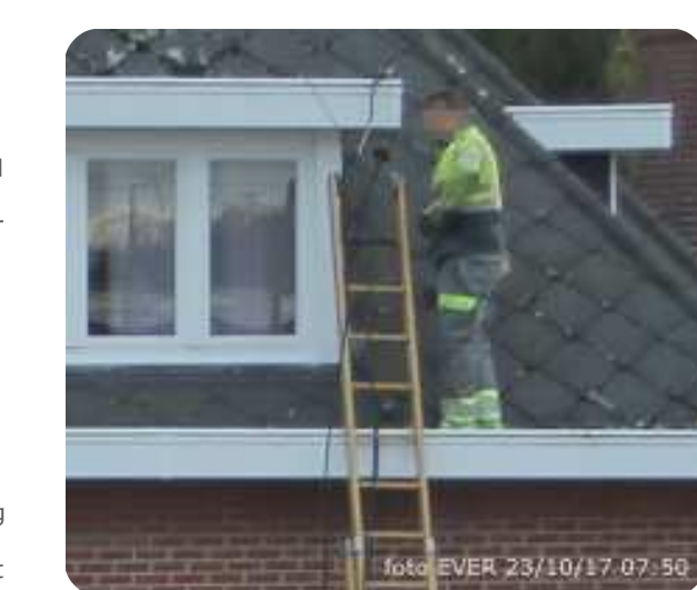
De aangestelde aan het onthaal bij EBN-Tech ontkende dat het bedrijf met ladders in de dakgoot klimt, dit was op 23 oktober 2017 om 07:50u toch wel het geval maar PBM werd op meer dan twee meter hoogte niet gebruikt.
