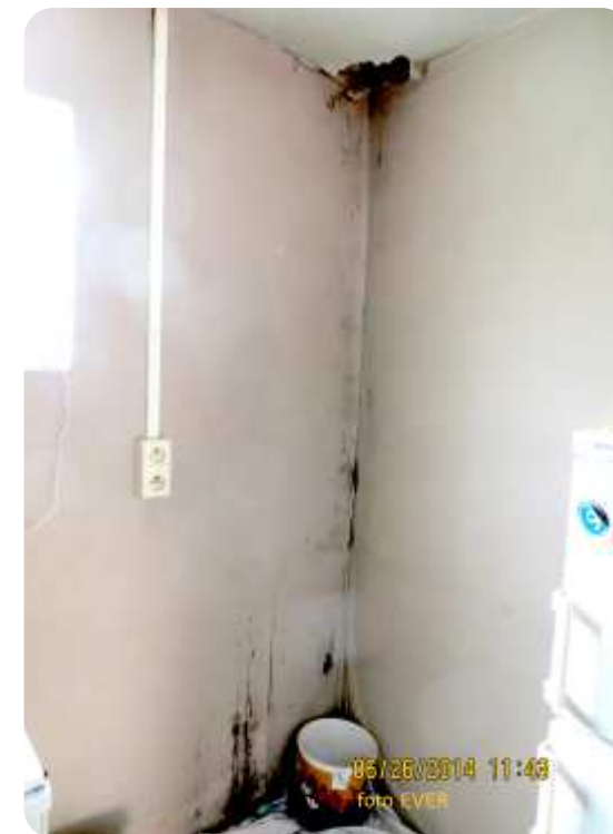
Gaten in het plafond, schimmel en vijf emmers om insijpelend water op te vangen. De verhuurder : OCMW Tremelo
