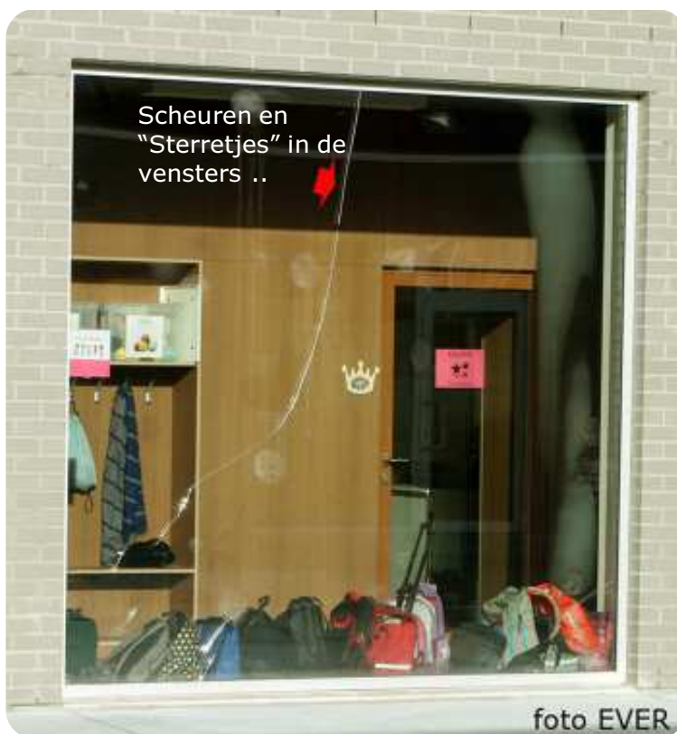
Twee van de dubbelglas ramen vertonen scheuren, we hoorden twee verschillende versies voor de oorzaak, waaronder één van de architect, wij geloven geen van beiden.
