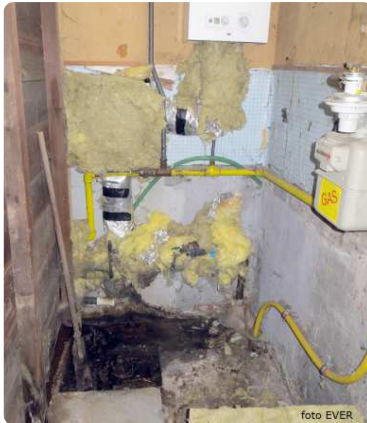
De afvalwaterput naast de douche in de schuur zonder geur afscheider, verspreidde een verpestende geur in de hele woning.
