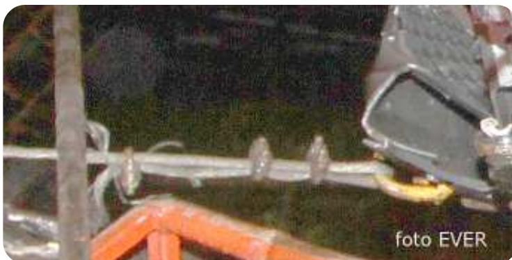
Dit kan helemaal niet door de beugel, "U" beugels, waarvan één verkeerd gemonteerd en geen kabeloog bij de bevestiging aan de haak. Ook geen draaivrije kabel.
