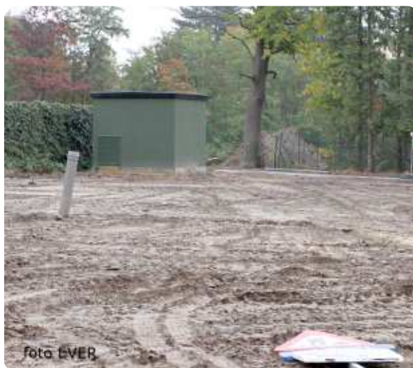
De nieuw ingeplande hoogspanningscabine is dankzij het defect nu ook meteen aangesloten, dat is een geluk bij een ongeluk.
