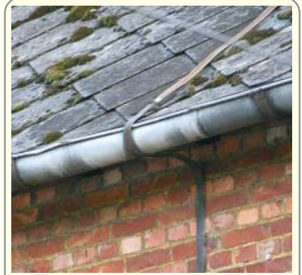
De koperen leiding ligt tegen de dakgoot en is niet verbonden.
