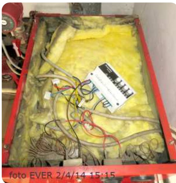
Sturing CV ligt onder het deksel -dat er voor de foto is afgenomen-. De technicus -?-, niet erkend door LNE, werd door het OCMW van Tremelo aangesteld en onterecht betaald.
