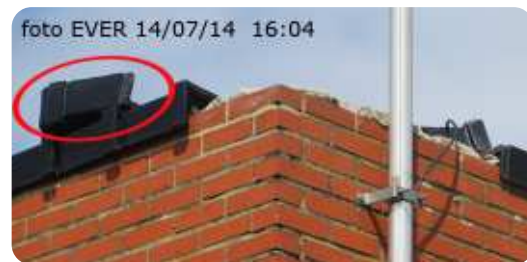
Gebouw van de technische dienst Tremelo : losliggende hoekpannen ...
