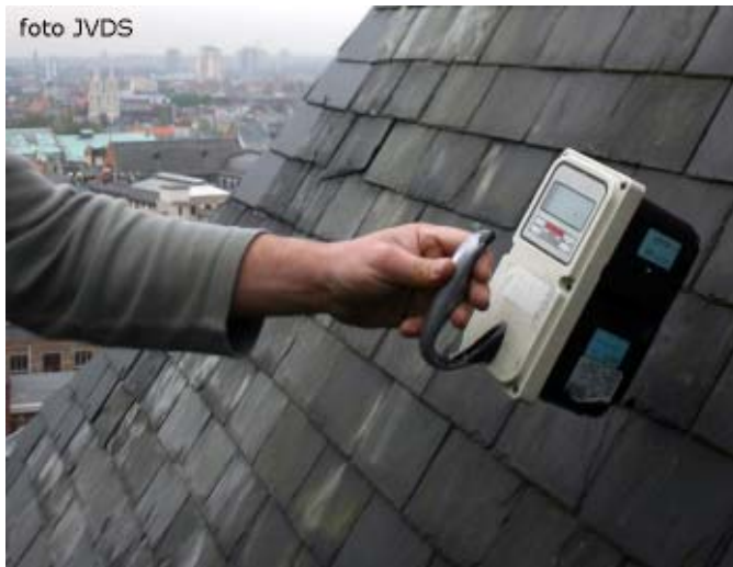
Meting door AVN toont aan dat het dak van de St Jacobskerk in Antwerpen meer dan 1.000 keer boven de toegelaten waarde met Radium 226 is besmet. Het FANC belette AVN later nog dergelijke besluiten te nemen ! AVN controleert ook de Kerncentrales .... Greenpeace trekt zich van dit soort dossiers niets aan, Jan Michiels van het FANC blijkt een goede bekende bij die showgroep te zijn.
