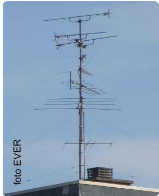
Deze gevaarlijke roestbui is niet geaard volgens de NBN C18-100 art. 4.4.2. en voldoet evenmin aan de wet van 19 december 1997 -niet limitatief-.
