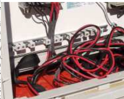
De UPS met onderaan een stel batterijen, als de gassen niet wegkunnen; kleine bommetjes.
