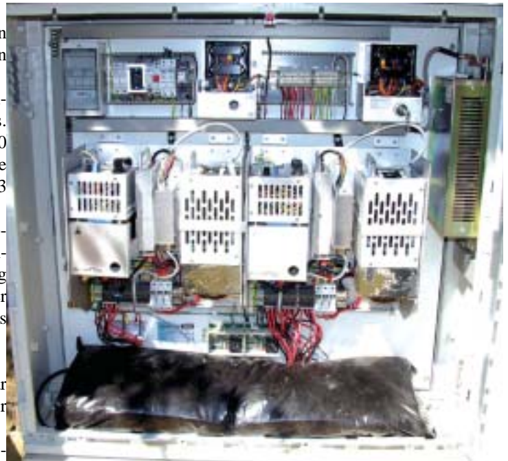
De UPS van Siemens - Kostenplaatje +/- 8.600 Euro - Honderden kunnen niet gebruikt worden bij gebrek aan software voor de bewaking.
