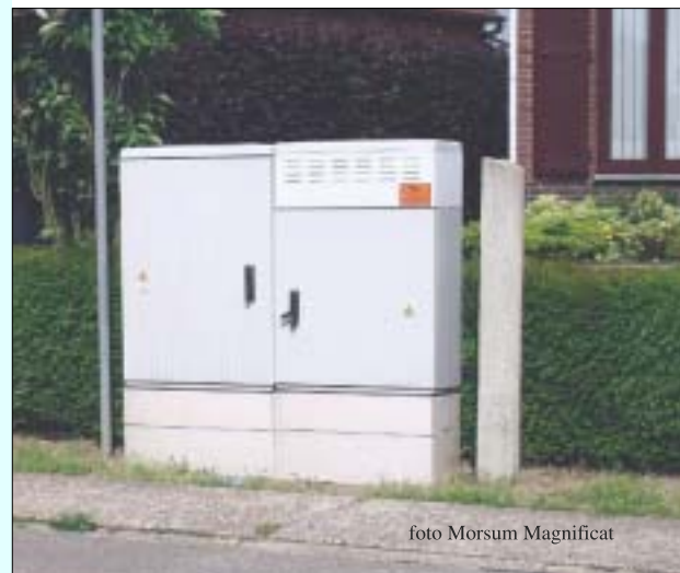
Als er 2 UPS van 650 Watt nodig zijn komt er nog een kast bij
