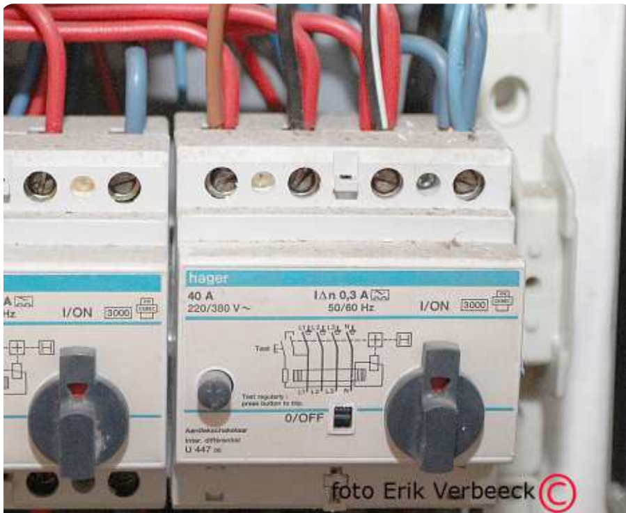
Differentieel niet verzegeld - geleiders van 2,5 en 4mm 2 onder dezelfde klemmen geplaatst - kring aan het begin niet beveiligd - Geen enkele beveiliging tegen kortsluiting van voeding onderbord 2, etc...
