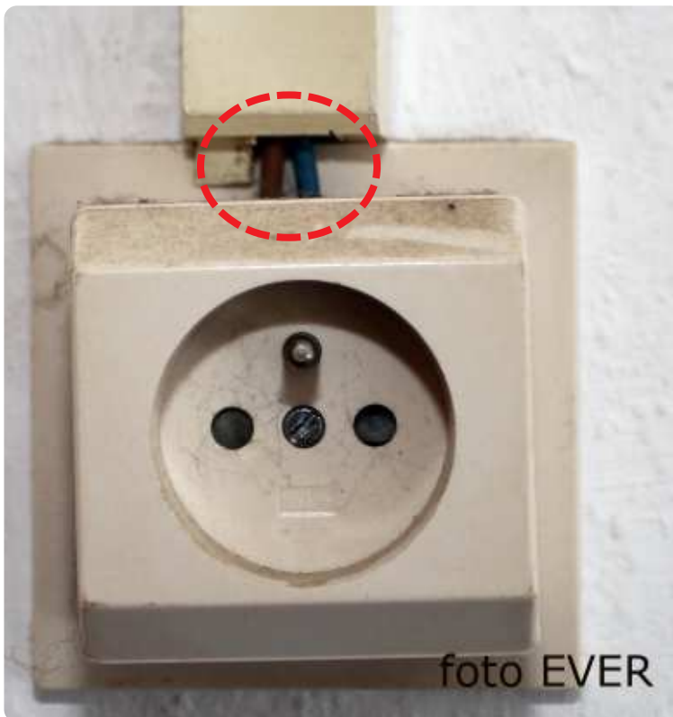
Dat hier geen aarding aanwezig is, is toch duidelijk !
