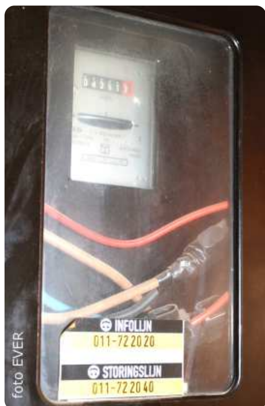
De oude meter van Infracx -Interelectra-.
