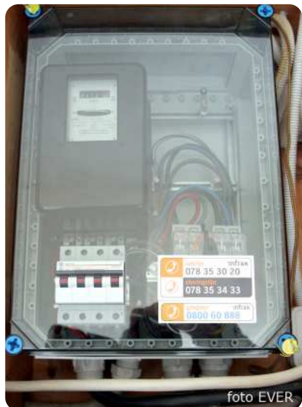
Infrac greep al binnen de week na de melding, terecht in. De ruimte is dermate krap dat de wartels niet correct geplaatst konden worden. De reden daarvan is dat Stefan P. en zijn vermeende elektriciens hun job niet naar behoren uitvoerden. Infrac zou meer haar op haar tanden moeten hebben en de eigenaar van het gebouw verplichten de nodige ruimte voor haar infrastructuur ter beschikking te stellen.
