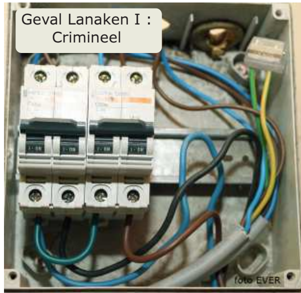
Geval I. Twee beschermingsgeleiders van de stopcontacten -boiler en wasmachine- met mekaar verbonden, maar niet op een aarding, noch op een differentieel aangesloten! Welke elektriciën durft zoiets te realiseren? In Lanaken is dat geen probleem !
