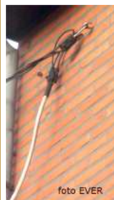
Aftakkabel hangt over de ganse lengte los
