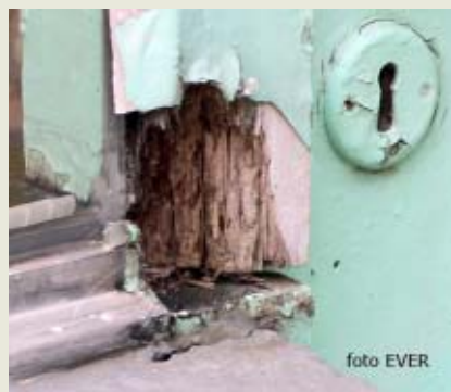
Deuromlijsting veranda : hout is rot
