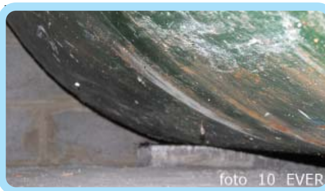
Foto 10 steun onder de tank
