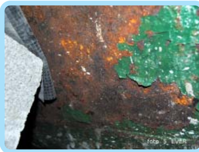
Foto 5 steun 2 en staat van de tank.
