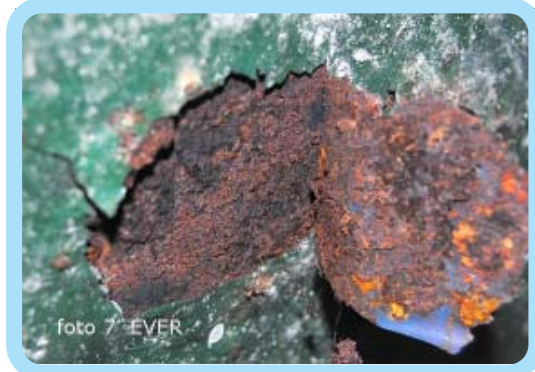
Foto 7 staat van de tank.
