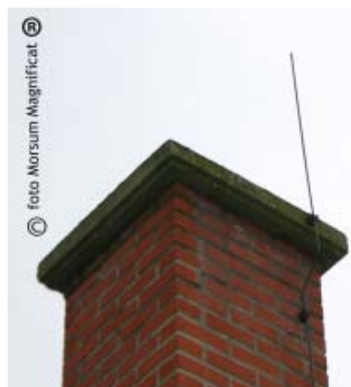
Verticale opvanger ter beveiliging van een schouw, een horizontale opvanger is ook goed. De opvangleiding moet op maximum 5 meter in twee daalleidingen worden gesplitst.
