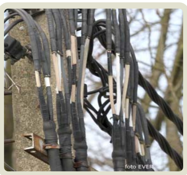
Voedingskabels -150 mm² EAXVB - waarvan de isolatie wegens de inwerking van de UV stralen is losgekomen, waardoor de spanning van 400 Volt genaakbaar is.
