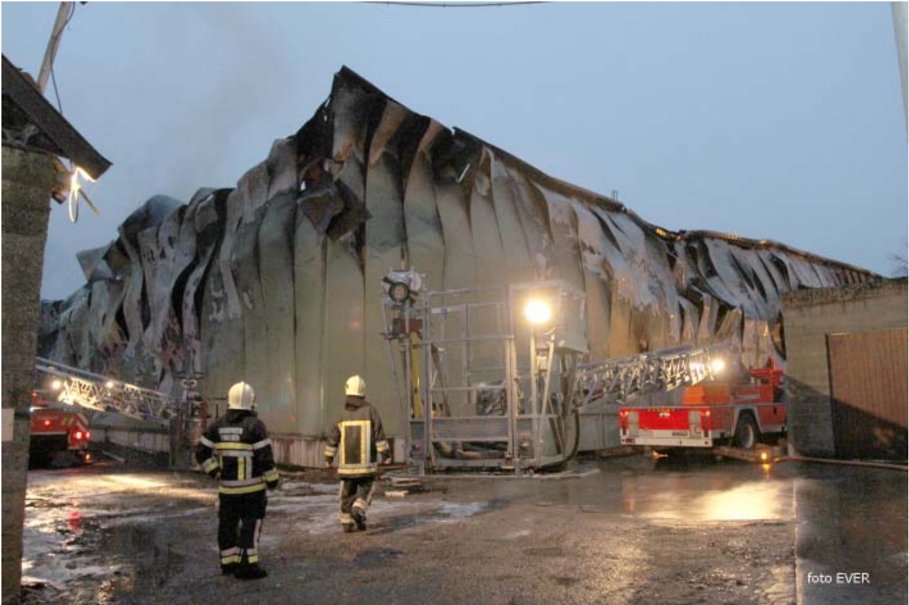
De ingestorte loods gaf door de brand allerlei giftige dampen vrij zoals dat steeds bij het verbranden van elektrische kabels, plastic etc. het geval is.
