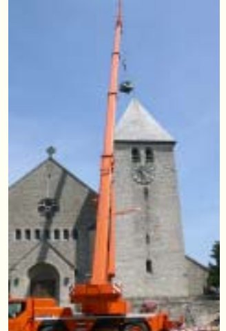
22.06.2005 - Eglise - Woluwe St Lambert Grue 50T Michielsens - Preventor Indelec enlevé.
