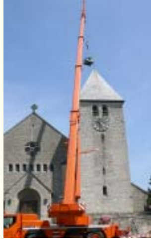
22.06.2005 - Eglise - Woluwe St Lambert Grue 50T Michielsens - Preventor Indelec enlevé.
