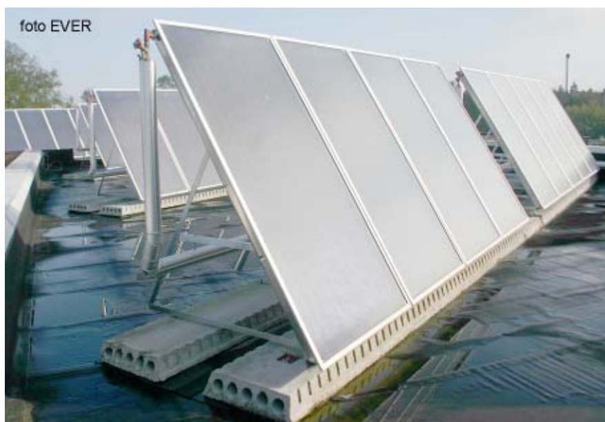
Zonnepanelen van 5 x 1,60m geen peelschil op het dak.
