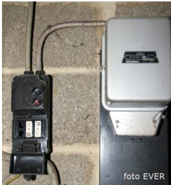
De pulsadis -rechtsboven- en de beveiliging tegen kortsluiting met penzekeringen van 15A -rechts-. Er is geen differentieel, geen van 300 en geen van 30mA!
