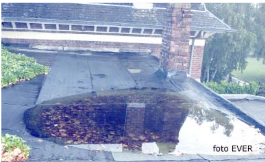
Dak van het verhuurde gelijkvloers aan de Oude Kring, de huurder klaagde over een lek in het plafond waarvan de tegels afvallen ...
