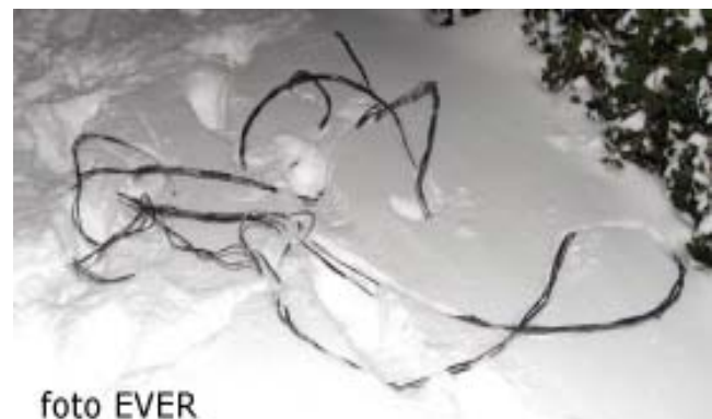
De wegens kortsluiting in de aftakking -B- doorgesmolten BAXB 16mm aftakkabel, 100 meter verder stroomopwaarts.
