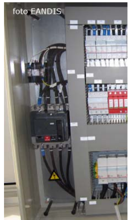
Volgens Morsum Magnificat heeft het Vei of Eandis hier een foutje begaan, art. 199 van het AREI heeft het over de blauwe kleur welke enkel voor de nulleider mag gebruikt worden, én : De voormelde kleurencombinatie is aanwezig over de ganse lengte van de geïsoleerde geleiders ..... en dat is hier niet het geval !
