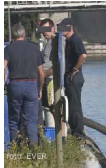
Binnen de draaicirkel van de kraan, op de rand van de kaaimuur en geen enkele PBM
